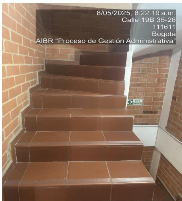
Imagen 46. Escaleras sin antideslizantes y barandas
