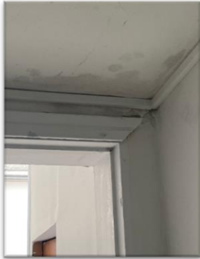
Fuente: Registro Fotográfico Visita Administrativa Contraloría de Bogotá Descripción: "Muestra humedad y mal olor en la habitación"
