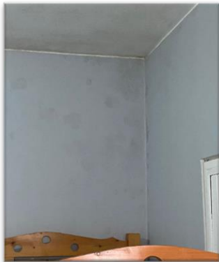
Fuente: Registro Fotográfico Visita Administrativa Contraloría de Bogotá Descripción: "Habitación con humedad, mal olor "
