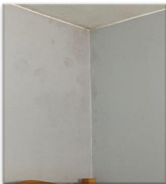
Imagen No. 60 Humedad en habitación
