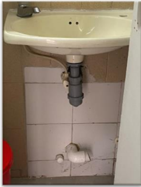
Imagen No.49 Lavamanos inservible
