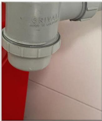
Imagen No. 50 Lavamanos con filtración de agua
